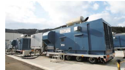
高圧電源車(1825kVA, 4台)
