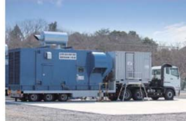
高圧電源車(1725kVA, 5台)
