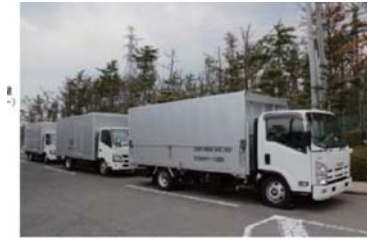
低圧電源車(500kVA, 4台)
