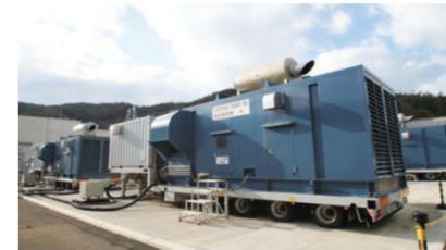
高圧電源車(1825kVA, 3台)
