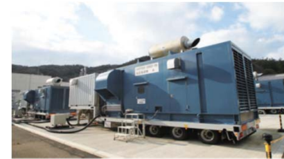
高圧電源車(1825kVA, 3台)
