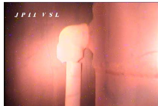
No. 1 計測管エルボ溶接部 破断状況（前回確認）
