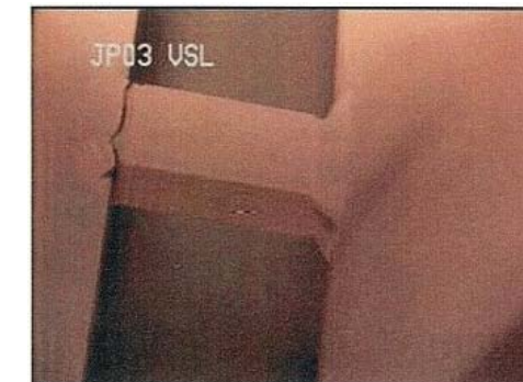
No. 3 計測管第1スタンドオフ溶接部 破断状況
