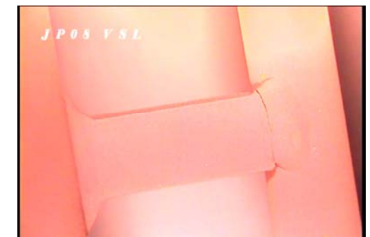
No. 8 計測管第2スタンドオフ溶接部 ひび割れ状況
