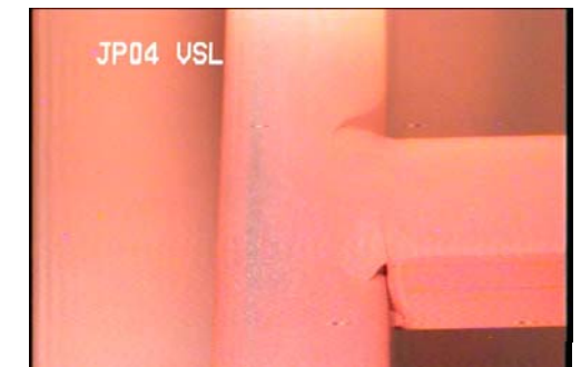
No. 4 計測管第2スタンドオフ溶接部 ひび割れ状況
