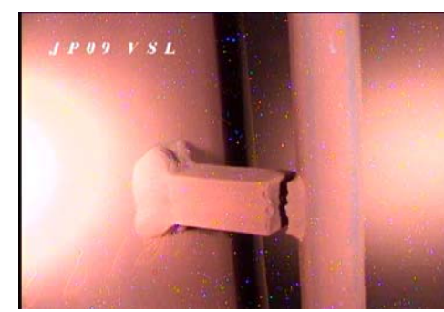
No. 9 計測管第1スタンドオフ溶接部 破断状況（前回確認）
