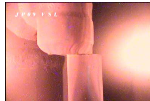
No. 9 計測管エルボ溶接部 破断状況（前回確認）
