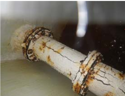
共通連絡配管 外観1 (配管外面に腐食は確認されたが漏えいはない)
