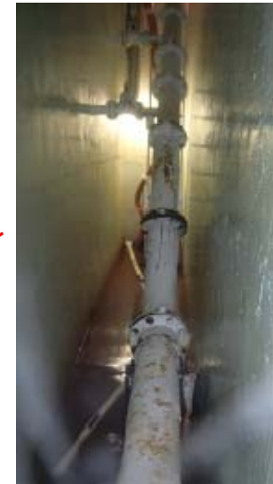
共通連絡配管 外観2 (配管外面に腐食は確認されたが漏えいはない)
