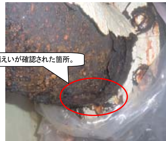
漏えい箇所拡大写真(A-A矢視図)
