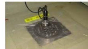
漏えい検知器の設置(例)
