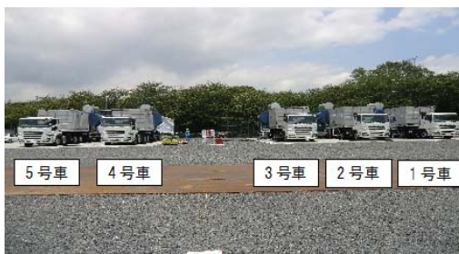
常設代替高圧電源装置（イメージ）
