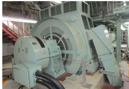
＜非常用ディーゼル発電機＞
