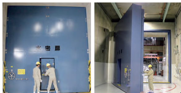
安全上重要な設備への浸水を防止(水密扉)
