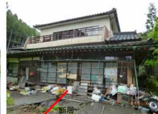
木造建物(D4, 直下の地表断層で傾斜)
