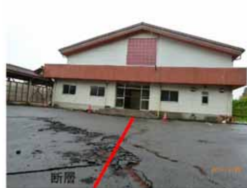
鉄骨造体育館と地表地震断層(D4)
