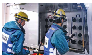
電源確保訓練 (電源車への接続)
