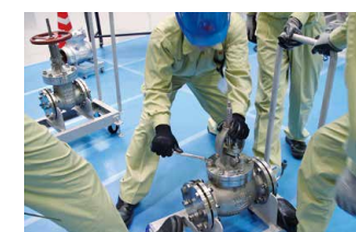
弁の点検訓練
