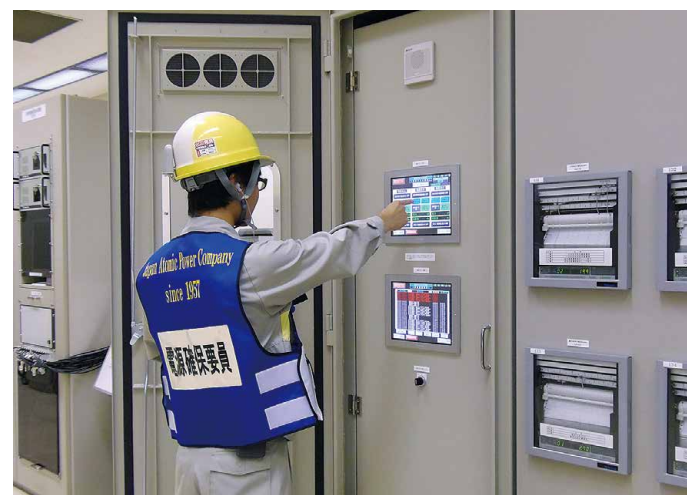
電源車の遠隔起動操作訓練
