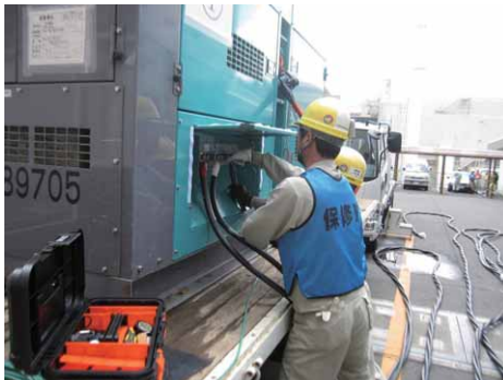
移動式電源からの電源接続訓練
