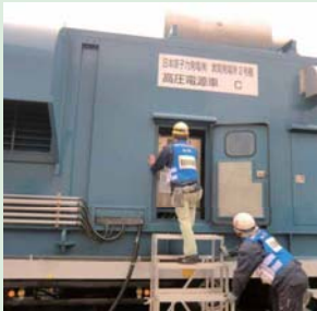
高圧電源車の起動操作訓練
