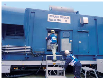
高圧電源車起動訓練
