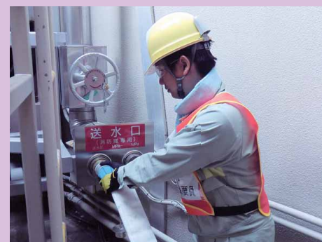
専用給水配管への接続口
