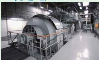
非常用ディーゼル発電機
