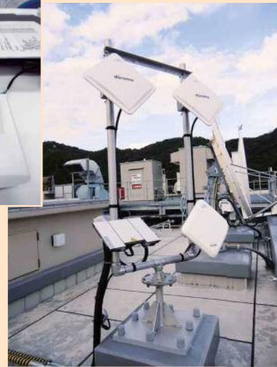
緊急時に発電所内外と通信を行う衛星電話用のアンテナ (緊急時対策室建屋の屋上に設置)
