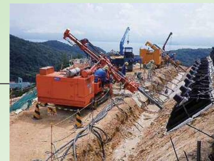
▲耐震裕度向上工事 (写真: 発電所斜面の大規模な地滑り防止工事) 2006年9月～
