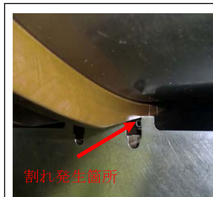
シールリング折損状況
