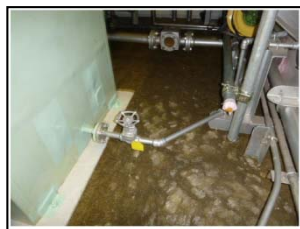
タンクベント処理装置室内 内部状況（たまり水発見時）
