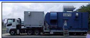
常設代替高圧電源装置及び同置場
