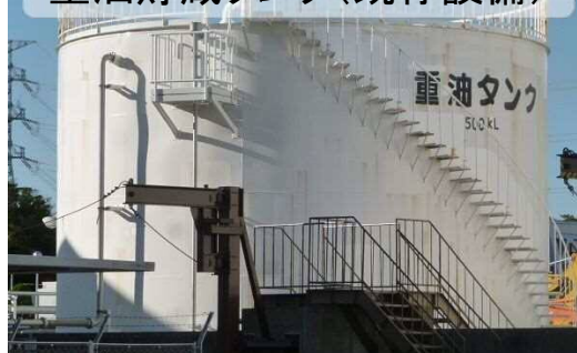
重油貯蔵タンク(既存設備)
