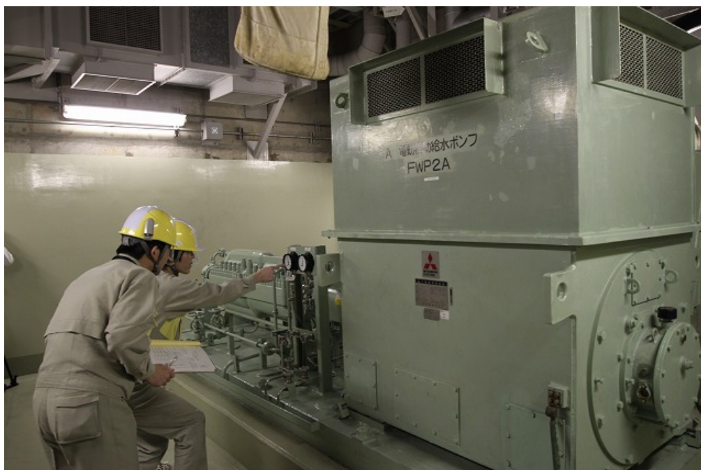
発電室員による電動補助給水ポンプの動作確認
