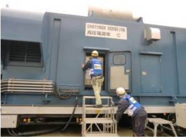
高圧電源車(1825)kVA 3 台の起動操作
