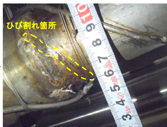
【洗浄水ドレン配管拡大写真】
