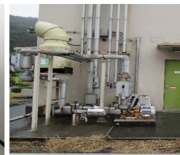
⑥冷却塔及びポンプ
