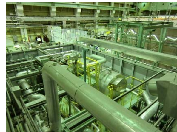
④タービングランド蒸気系
