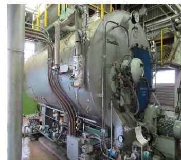
③補助ボイラー
