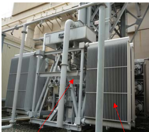
所内変圧器外観
