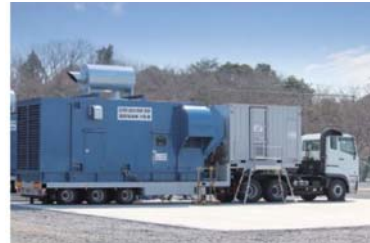
高圧電源車(1725kVA, 5台)
