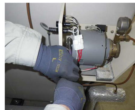
【当該加湿器電動機の手回し確認】
