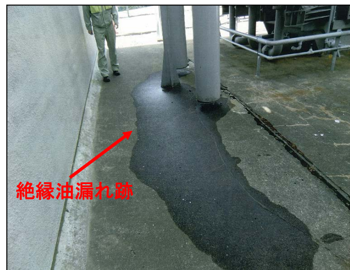
起動変圧器2B
