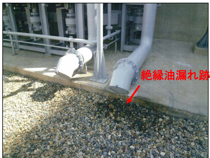
起動変圧器2A
