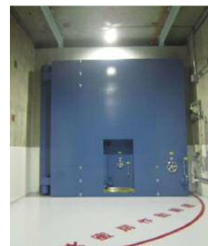
＜水密扉の設置例＞ (原子炉建屋機器搬入口扉)
