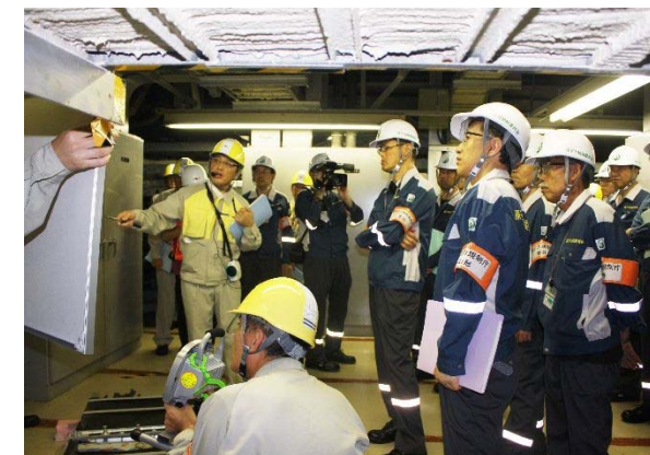
非難燃ケーブルの防火措置についての説明
