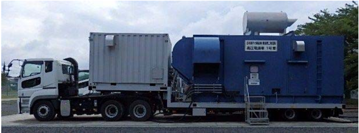
常設代替高圧電源装置 外観
