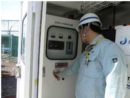
可搬型窒素供給装置（小型）起動
