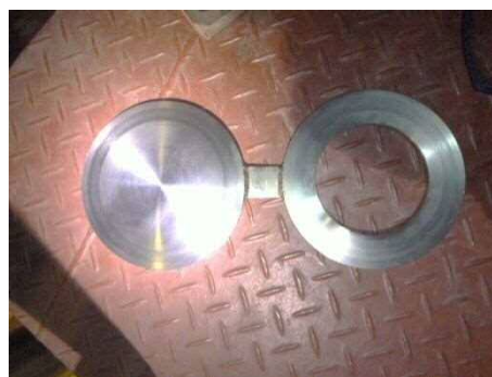
連絡配管閉止フランジ
