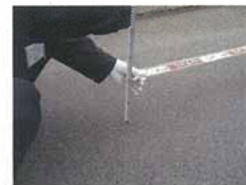
路面の沈下(沈下量20cm)
