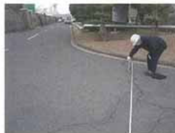
ドライキヤスク前道路のひび割れ状況 (ひび割れ及び一部2cm程度の段差)
