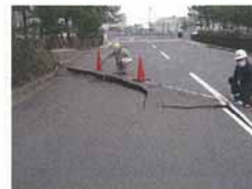
路面のひび割れ(長さ8m)
