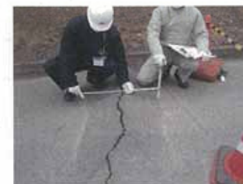
路面のひび割れと盛り上がり(陸側) (幅2cm、長さ2.5m、高さ10cm)
