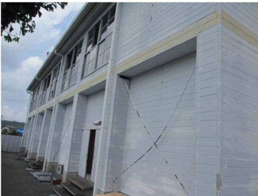
筋かい材の変形
