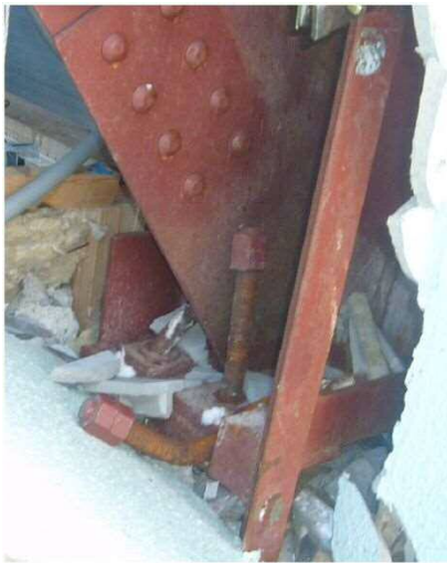
アンカーボルト引き抜け
