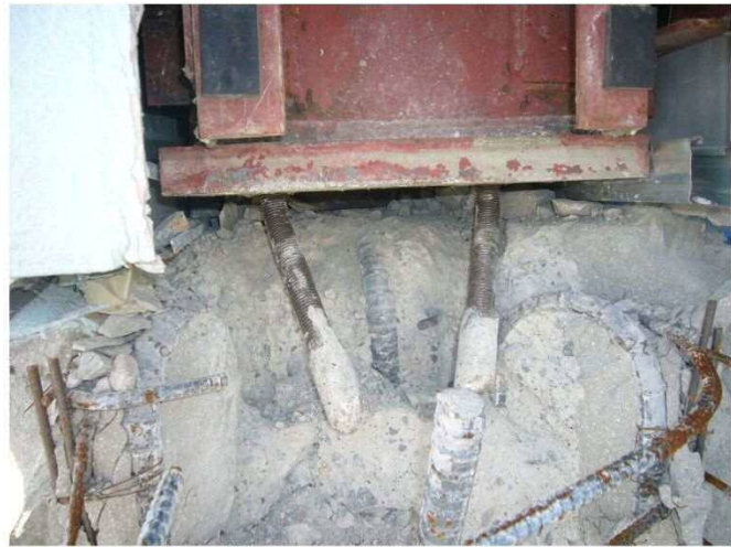
柱脚部コンクリート破壊
