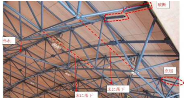
筋かい材の座屈・落下
