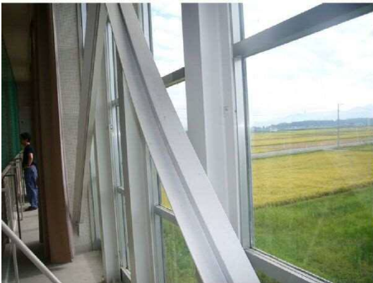
筋かい材の座屈（刈羽村）
