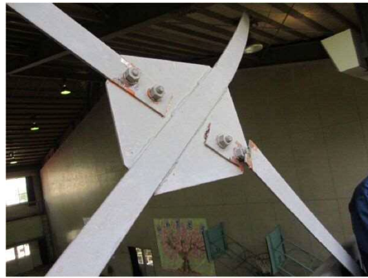
ブレース孔欠損部の破断
