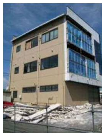
ALC パネルの脱落
