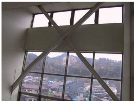
ブレース材の座屈
