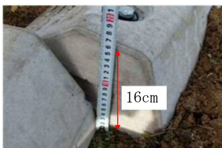
【段差復旧検証用段差】
