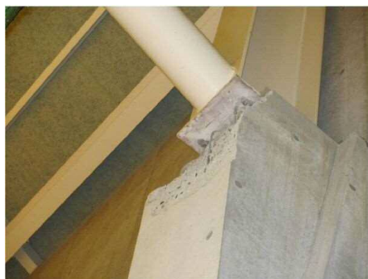
支承部コンクリート側方破壊
