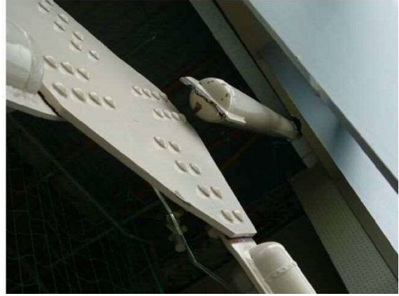
筋かい材プレート破断
