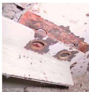
筋かい材ボルト破断
