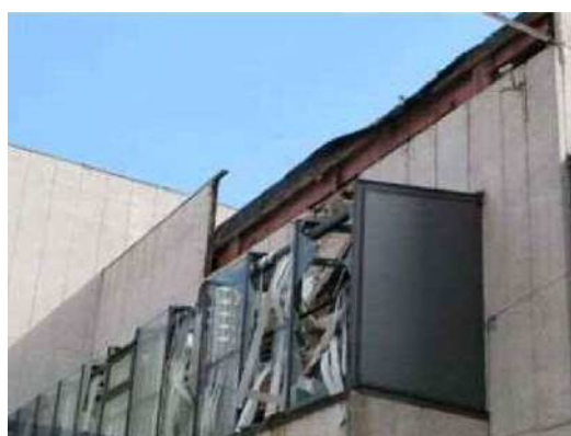
外装材の脱落，ガラス破損
