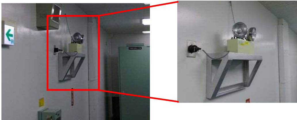
第2図 蓄電池内蔵型の照明
