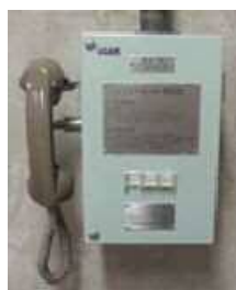
運転指令設備 (ページング)
