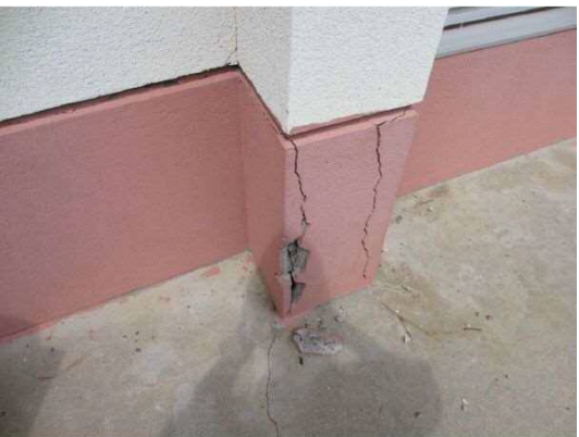
柱脚部コンクリートのひび割れ
