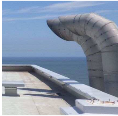
図 5 ディーゼル発電機 排気管
