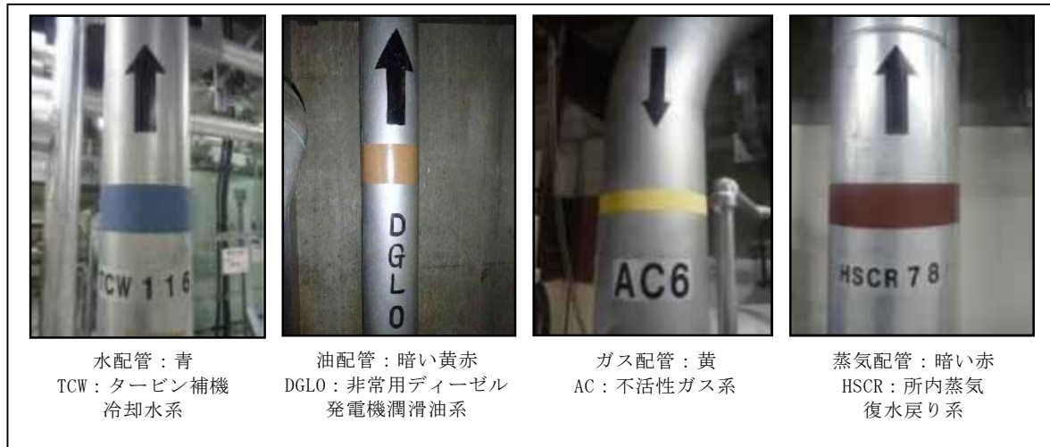
第 2.4.2-2 図 配管の識別管理（例）
