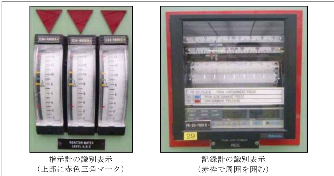
第 2.4.1-6 図 重要指示計等の識別表示（例）
