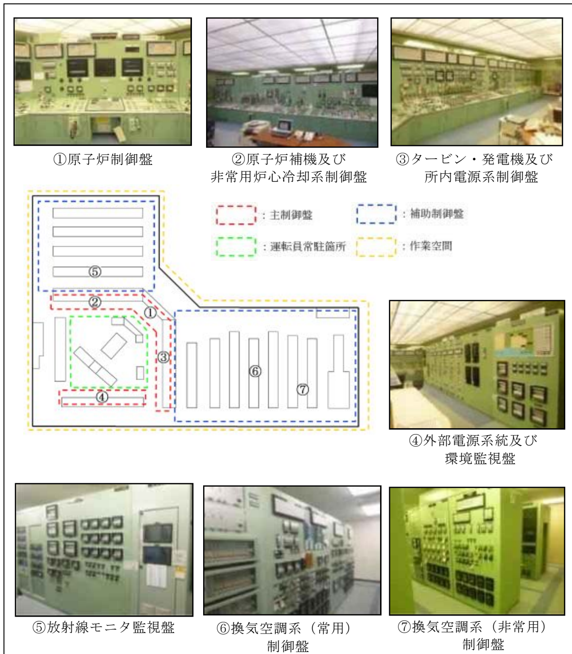
第 2.4.1-1 図 中央制御室の制御盤配置
