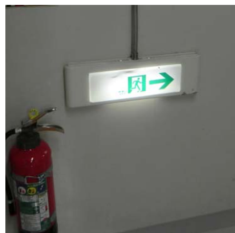
通路誘導灯（廊下・通路）
