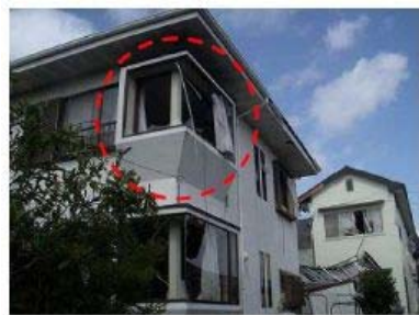
出窓部の窓ガラスの損壊
