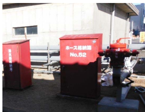
#153 消火設備格納箱
