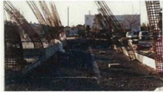
曲がった鉄筋（工事現場）
