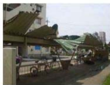
駐車場の折板屋根の著しい変形
