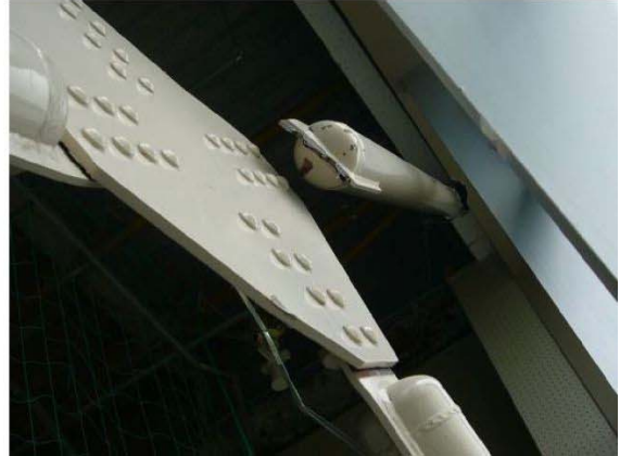
筋かい材プレート破断
