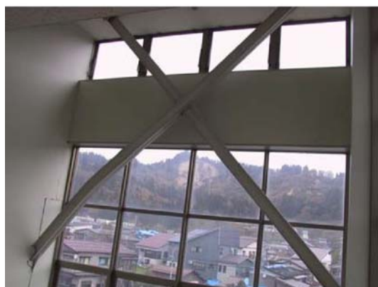
ブレース材の座屈
