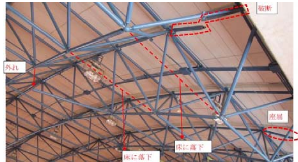
筋かい材の座屈・落下
