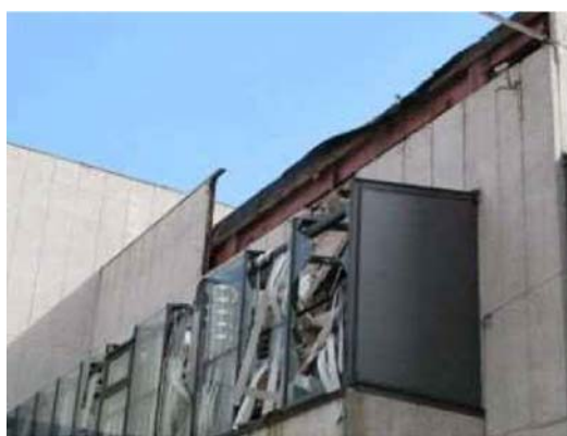
外装材の脱落，ガラス破損
