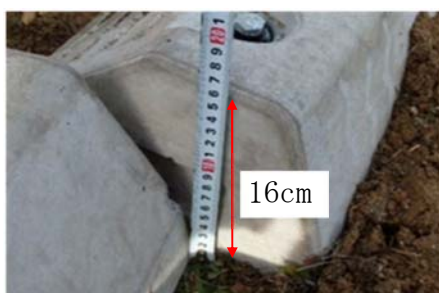
【段差復旧検証用段差】
