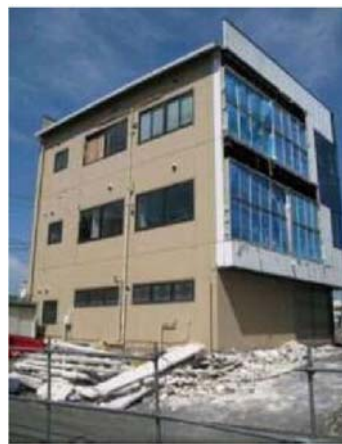
ALC パネルの脱落
