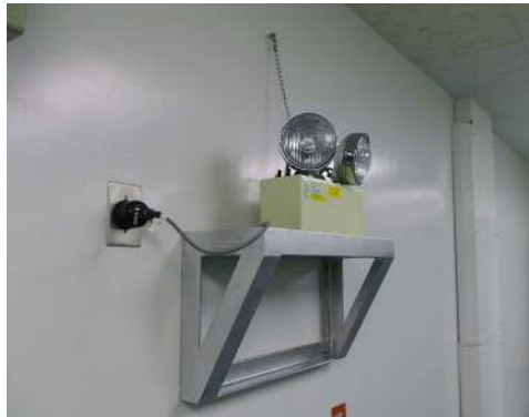
第 1.0.13-6 図 蓄電池内蔵型照明の例
