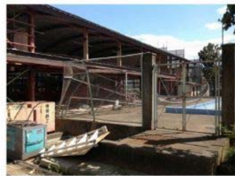
フェンスの変形（工事中の建築物）
