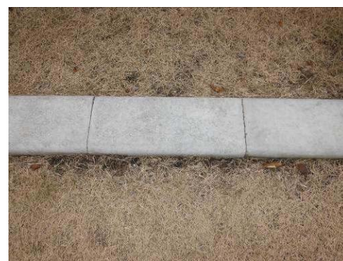
#81 コンクリート製蓋
