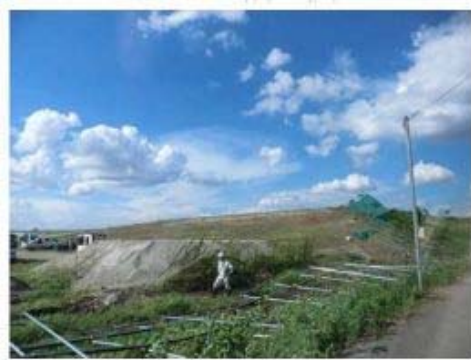
フェンスの倒壊
