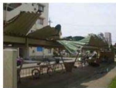
駐車場の折板屋根の著しい変形
