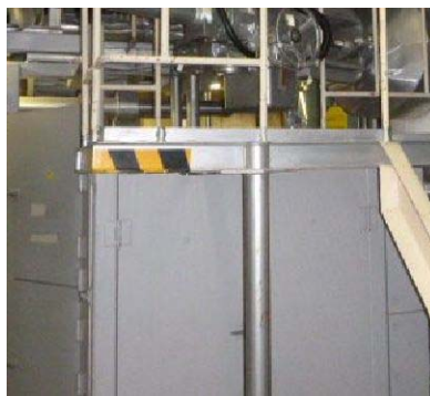
電動弁(遮蔽内に設置)
