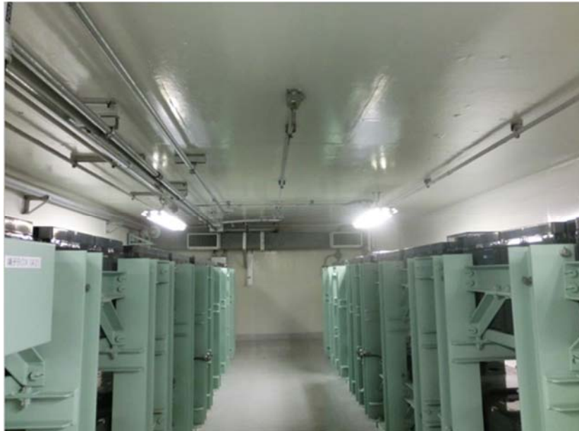
第41-1-41図 蓄電池の設置状況
