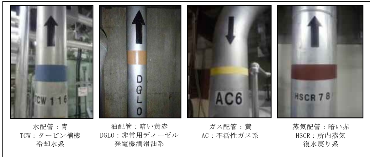
第 2.4.2-2 図 配管の識別管理（例）
