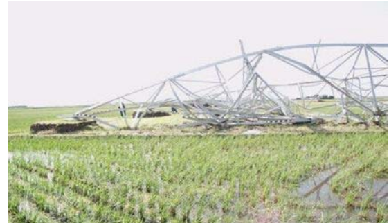
強風による鉄塔の倒壊事例②※ 1
