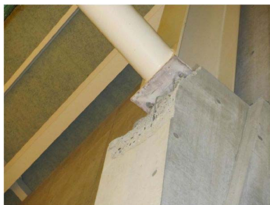
支承部コンクリート側方破壊
