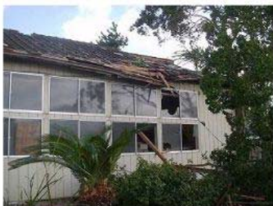
倉庫の窓ガラスと屋根の被害状況
