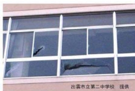
体育館窓ガラスの損壊
