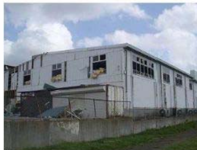
窓ガラスの損壊
