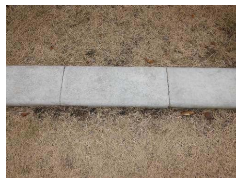
#81 コンクリート製蓋
