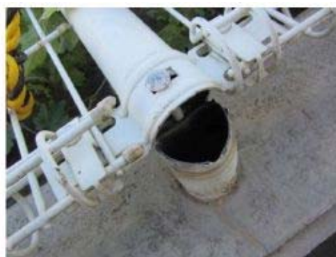
フェンス支柱部の破損
