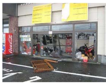
エントランスのガラス損壊
