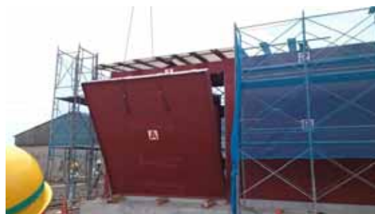
パネル開放状況
